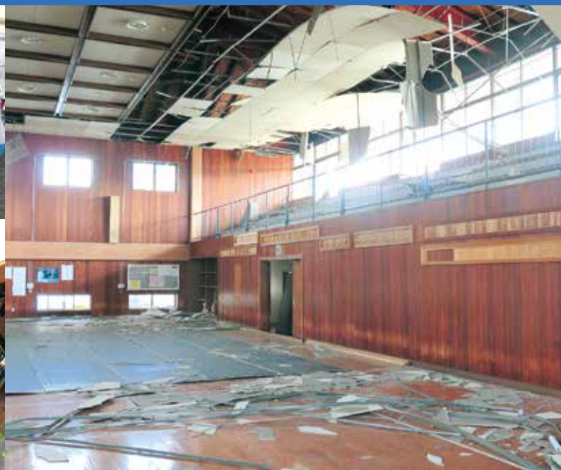
被災した武道場
