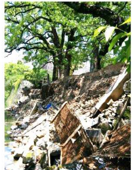
▼ 備前堀石垣の崩落による続櫓の倒壊
