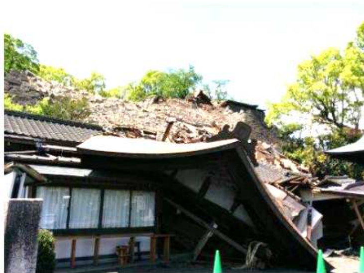
▼ 東十八間櫓と石垣崩落(手前は熊本大神宮社務所)
