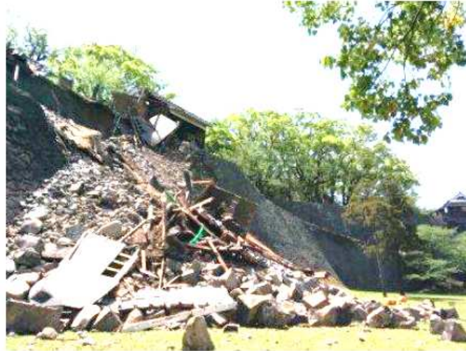
▼ 北十八間櫓と石垣（倒壊）
