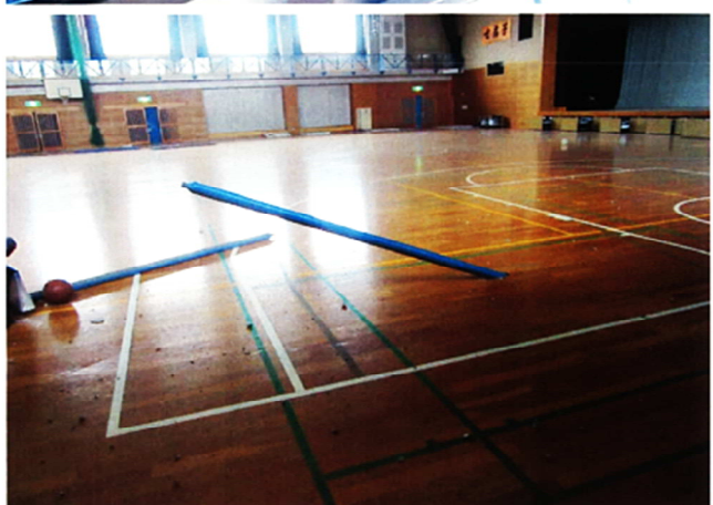
体育館 屋根トラス部材の落下
