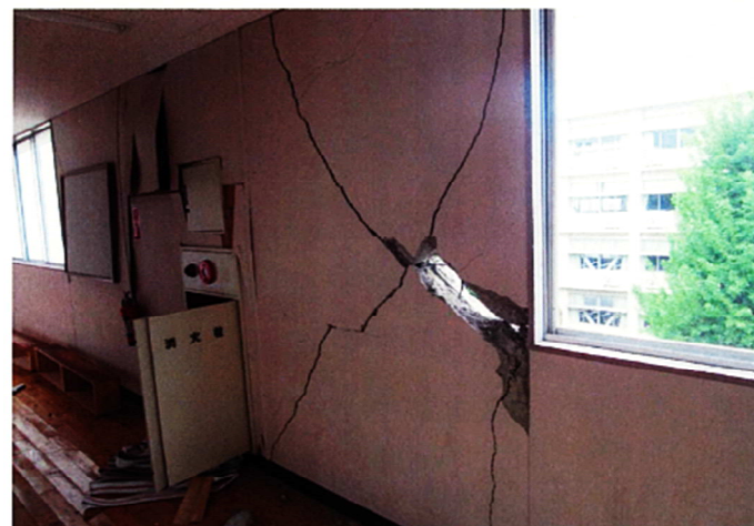
管理特別教室棟 廊下壁の顕著なひび
