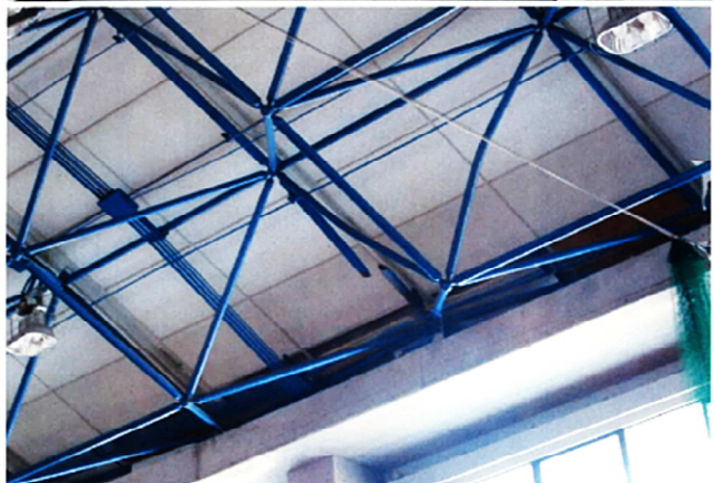
体育館 屋根トラス破断状況
