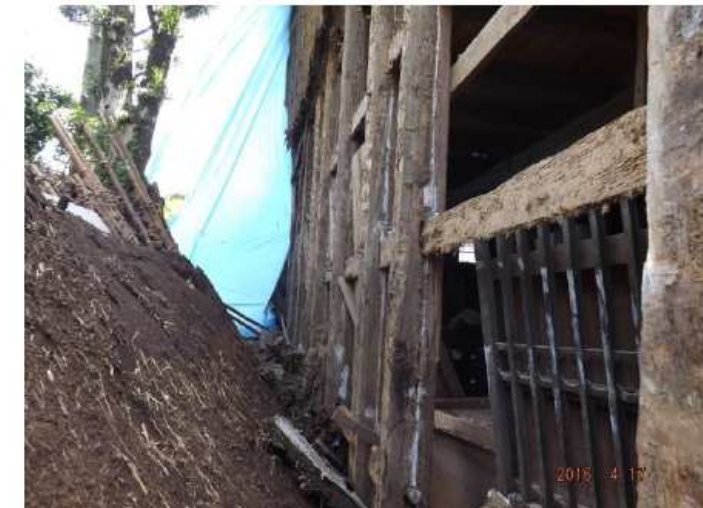
▼ 国 江藤家住宅（壁の崩落）
