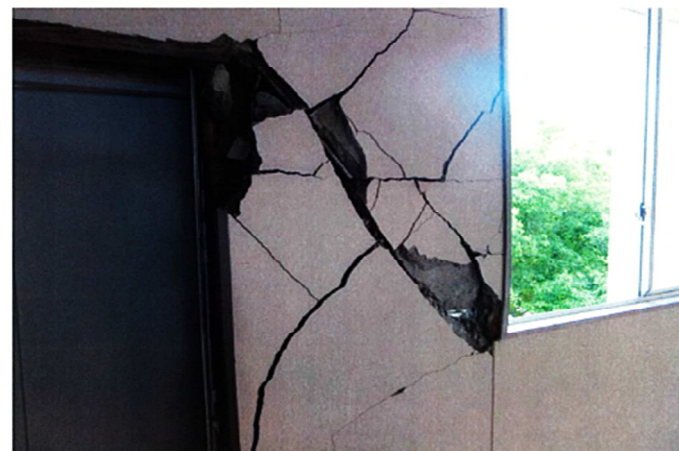
管理特別教室棟 廊下壁の顕著なひび
